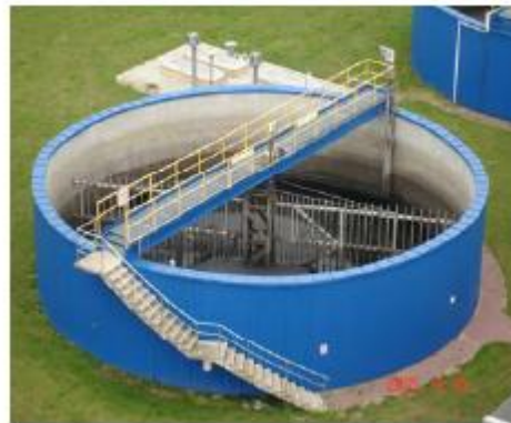
Rysunek 4. Zagęszczacz grawitacyjny pracujący w sposób ciągły (Wrocławska Oczyszczalnia Ścieków)
