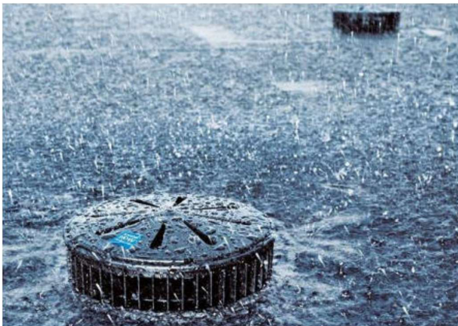
Rys.14. Praca wpustów dachowych
