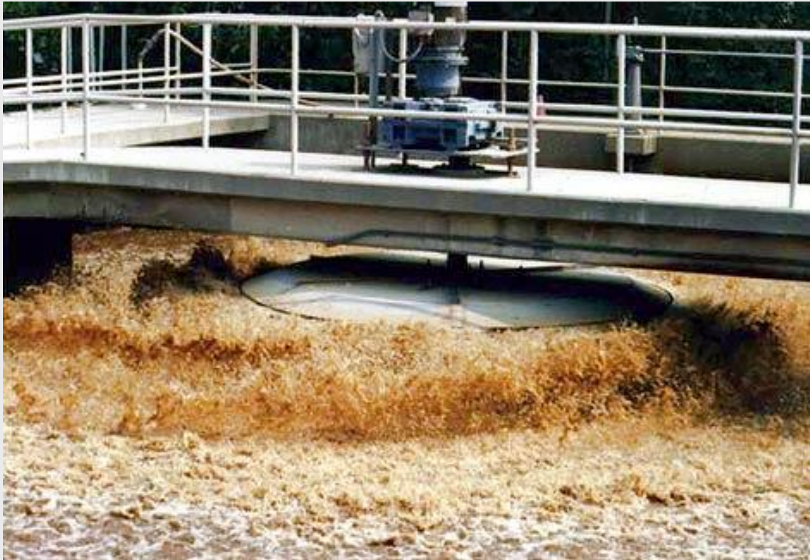
Napowietrzanie aeratorem mechanicznym o wale pionowym
